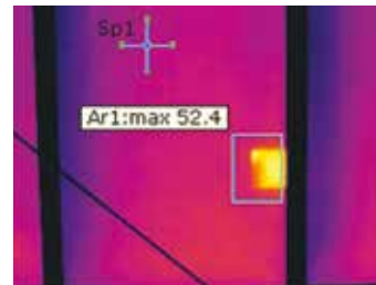
Esta termografía muestra un punto caliente provocado por la rotura de celdas en una placa estándar de 60 celdas.
