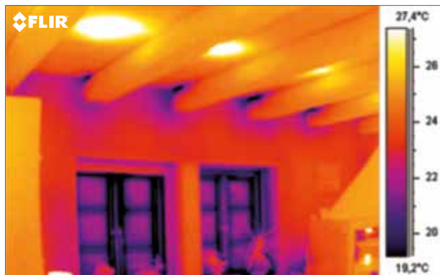
La termografía muestra puentes térmicos entre las vigas del techo y las paredes adyacentes.
